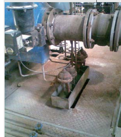
被腐蚀的浮球排水器
