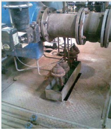
被腐蚀的浮球排水器
